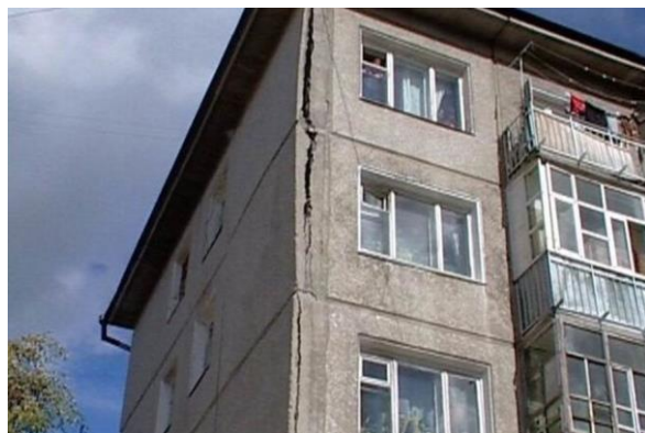
Рисунок 2 –Трещина в стене панельного дома
