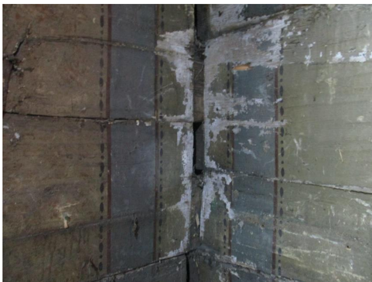
Рис. 2. Місця ушкодження стін пліснявими грибами у храмі
